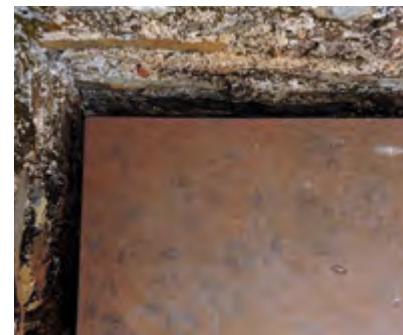
Pavimento desligado da antiga estrutura.
